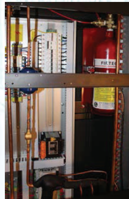
Sistema contra incendio
